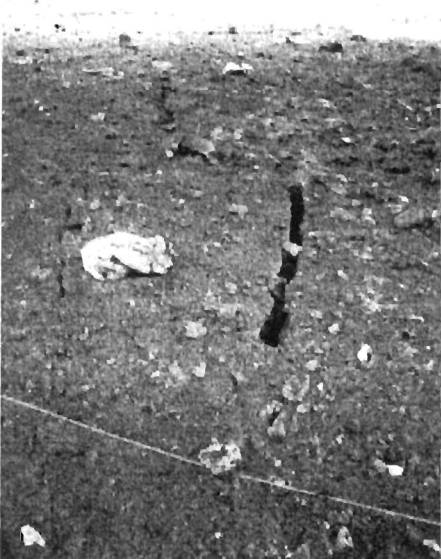
Рис.5.1.27. Закольные трещины на промышленном блоке
